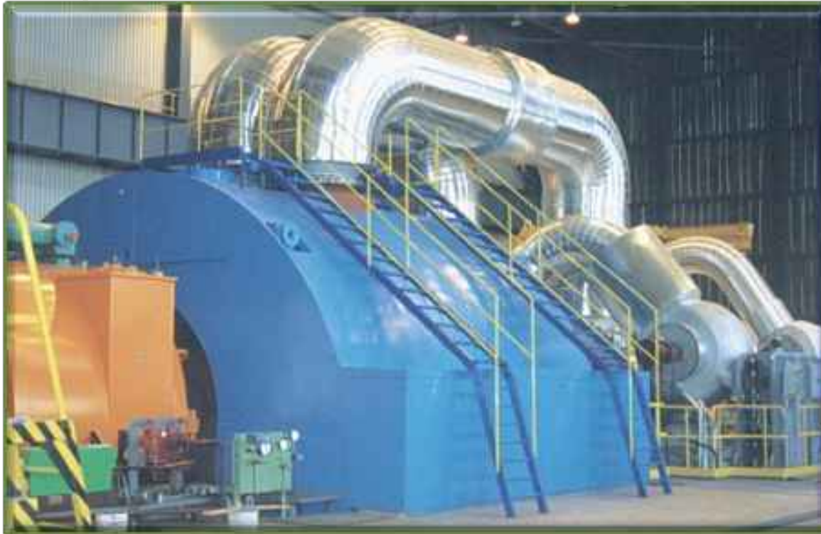
Obudowa dźwiękochłonna izolacyjna turbiny. Skuteczność 33 dB(A)
